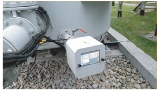
写真2 絶縁油中溶存ガスの常時監視装置の外観 2)
