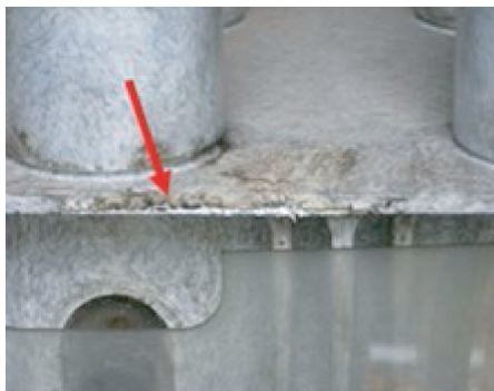
写真1 沿面放電の事例 1)
